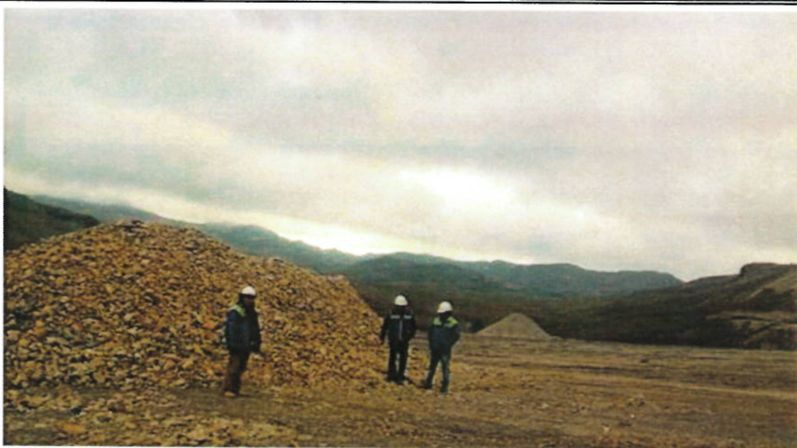
FOTO: SUPERVISION VERIFICANDO CANTERA QUEBRADA HONDA, SE EVIDENCIA FALTA DE PRODUCCION DE AGREGADOS.
