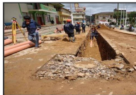
ALCANTARILLADO DE CUTERVO
