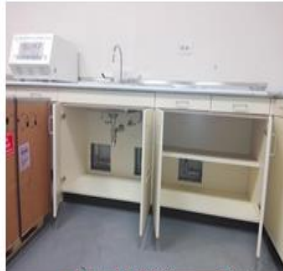
Válvulas de control sin tapas
