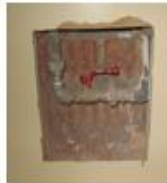
NO SE REALIZO CUBRIRSE NI TERNIADO EN CAJA DE PASO
