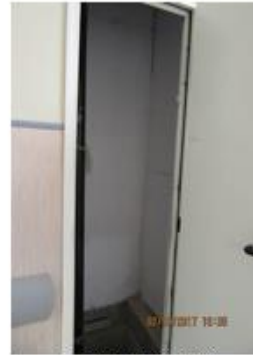
NO SE REALIZO ACABADO EN DUCIOS DE INSTALACIONES
