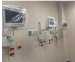
Equipos de monitoreo de 8 canales
